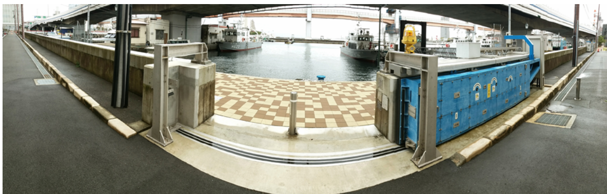
Figura N°7. Compuertas que se cierran automáticamente ante la inminencia de tsunamis y tifones en Kobe, Japón, en 2019
